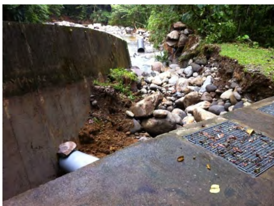
Le mur se désolidarise du dessableur
