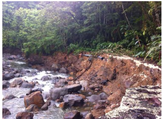
La voie d'accès à la prise est à reprendre totalement
