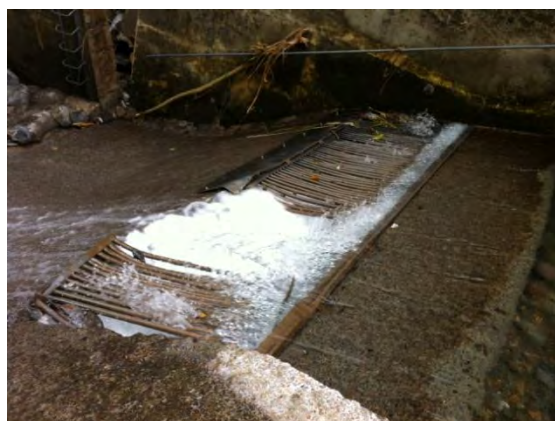
Les grilles sont déformées ou absentes
