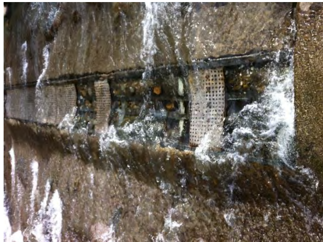
Les grilles sont déformées ou absentes
