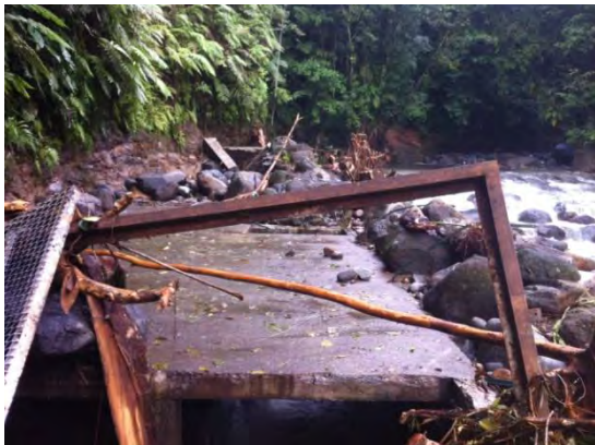
Les grilles du dessableur ont été déformées ou absentes
